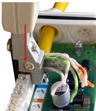
Fig. 13: Cables de red conectados mediante la herramienta LSA+/Krone
