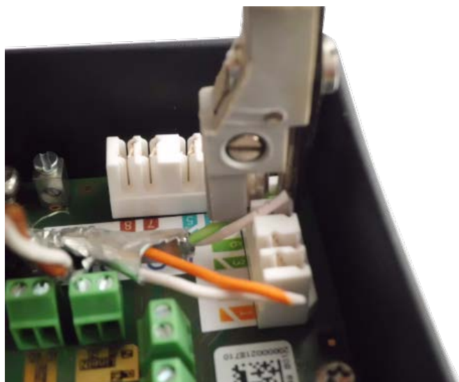
Fig. 26: Cables de red conectados mediante la herramienta LSA+/Krone
